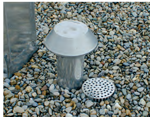
Ablauf, Entlüftungsrohr und Kaminbekleidung aus Edelstahl Rostfrei auf einem Flachdach mit Kiesdeckung
